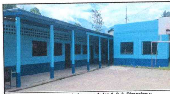
FOTO 6: Pintura en muros exteriores en Aulas 1, 2, 3 Dirección y Corredor.
